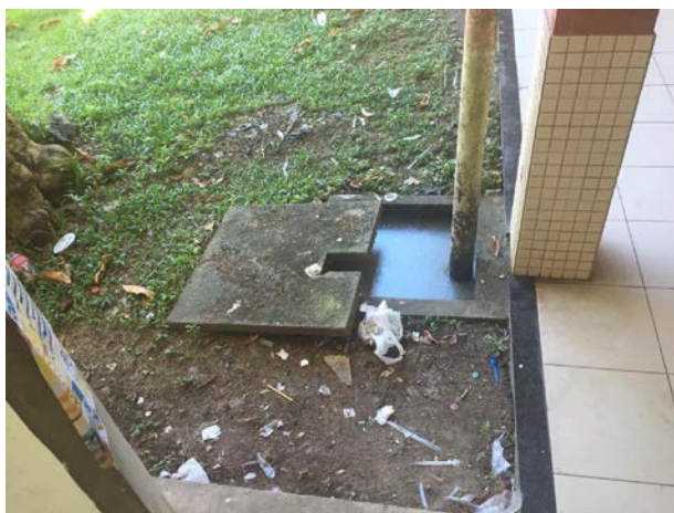
Figura 7: Acúmulo de água na caixa de areia.
